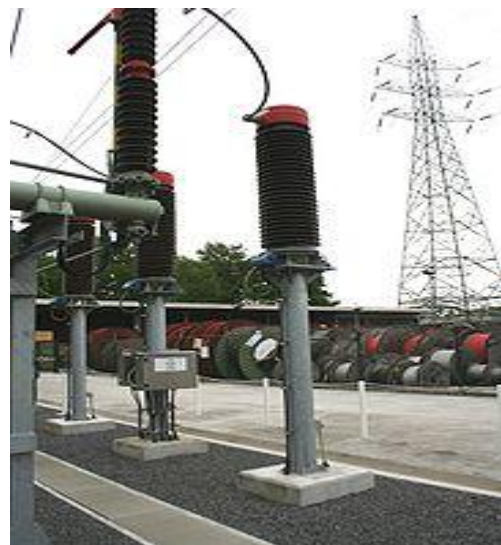
Figure III.3. Transformateur de potentiel 150kV
